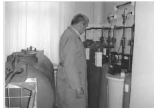
Фото 5. Технологія попередньої очистки води для гемодіалізу.
